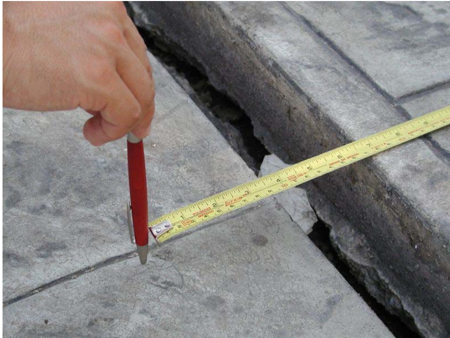
Figura 4 Asentamiento en estacionamiento, Muelle Municipal, Manzanillo
