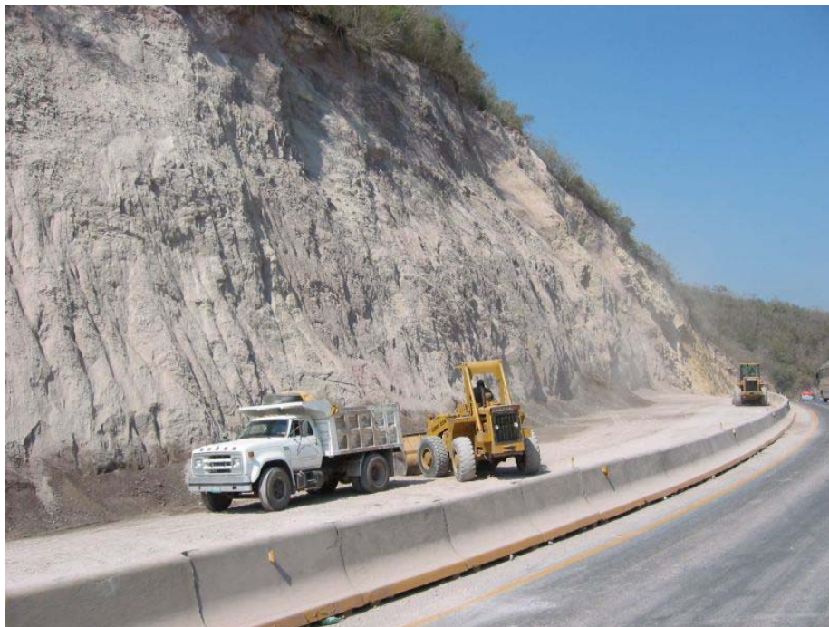
Figura 5 Derrumbes en Autopista 110 entre Manzanillo y Colima
