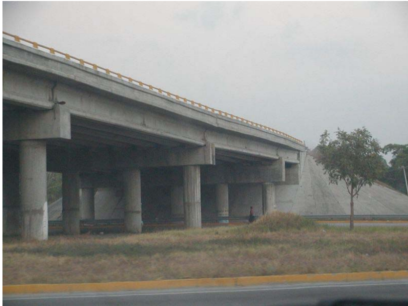
Figura 6 Daños a puente
