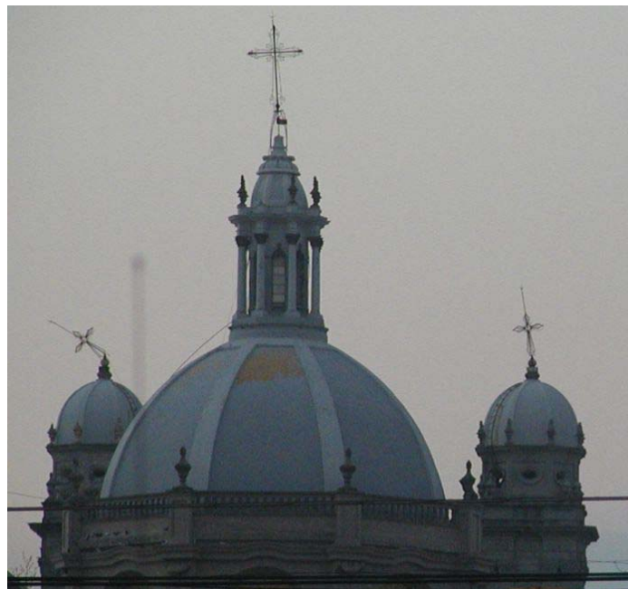
Figura 1 Daños a las cruces de la Catedral, Colima
